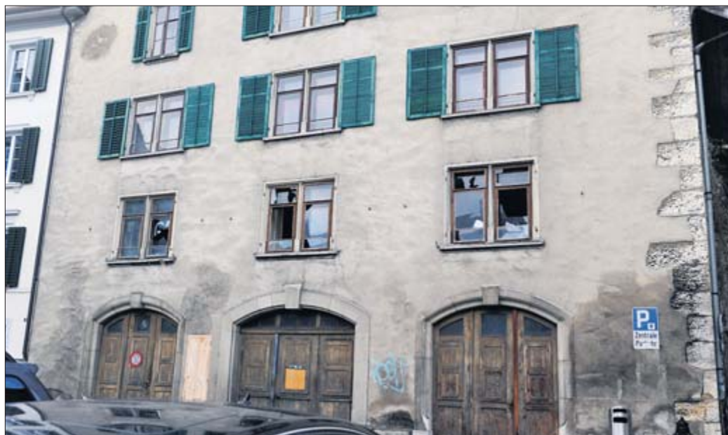
Die Scheiben wurden mittlerweile ersetzt. Erledigt ist die Sache aber noch nicht.
